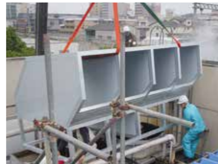
組み立てた新設サイレンサーをレッカーでつり上げ、クーリングタワー本体へ設置。
