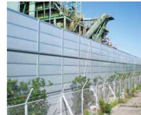
プラント設備
