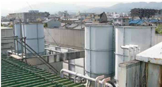
クーリングタワー排気ファンの運転音が敷地境界へ影響。
