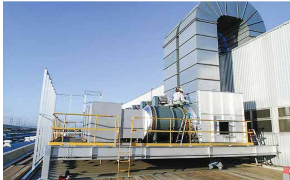
工場の脱臭装置の運転音が敷地境界に影響。折板屋根/高所の設備ということもあり、騒音対策が難しいとされていました。
